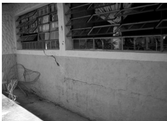
Fig. 13. Agrietamiento por asentamiento en paredes del Centro Escolar Especial No. 1
