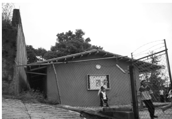
Fig. 11. U.E. Loma de la Virgen Baja donde se observa el muro estabilizador con una aparente inclinación ante el empuje del terreno.
