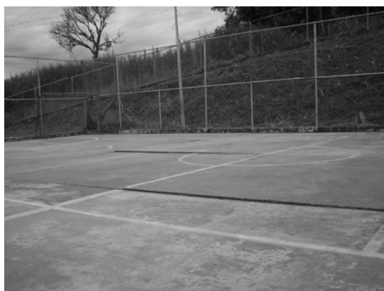
Fig. 12. Cancha deportiva U.E. los Maitines con desniveles producto de asentamientos diferenciales del terreno
