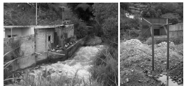
Fig. 8. (Izq.) Cercanía del río La Pedregosa con la U.E. Ramón Ignacio Guerra, (Der.) Daños ocasionados durante la crecida del río
