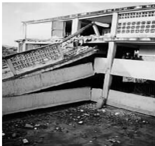
Fig. 7. Colapso del primer piso de los cuatro del Liceo Raimundo Martínez en Cariaco (1997)
