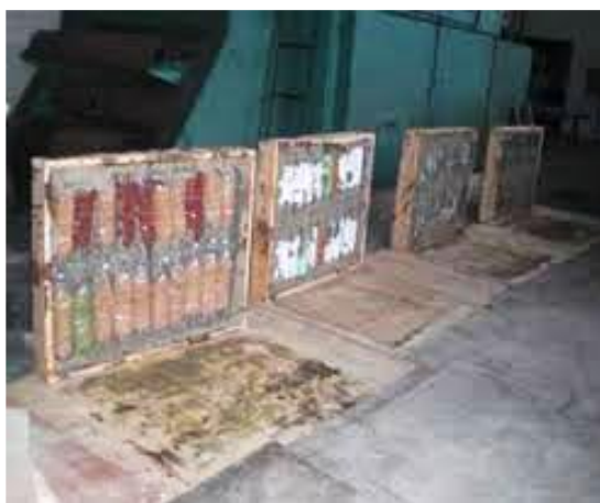
FIGURA 12. Formaleta con el vaciado de la mezcla sobre las botellas. Contreras Owen et al. (2012).
