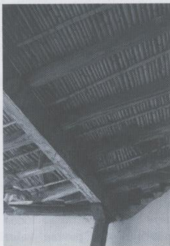
Fig. 1 Deterioro en cubierta
