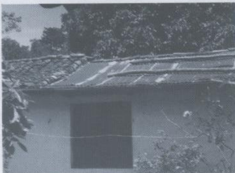
Fig. 3 Deterioro en techos y muros
