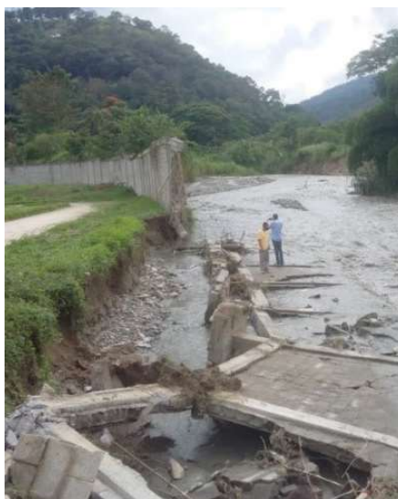
FIGURA 5. La quebrada Mejía causa daños a las instalaciones del Polideportivo 'Simón Bolívar', Santa Cruz de Mora, agosto 2021
