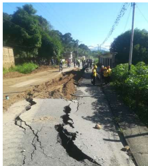
FIGURA 6. Falla de borde en el sector Quebrada del Barro, Santa Cruz de Mora, agosto 2021
