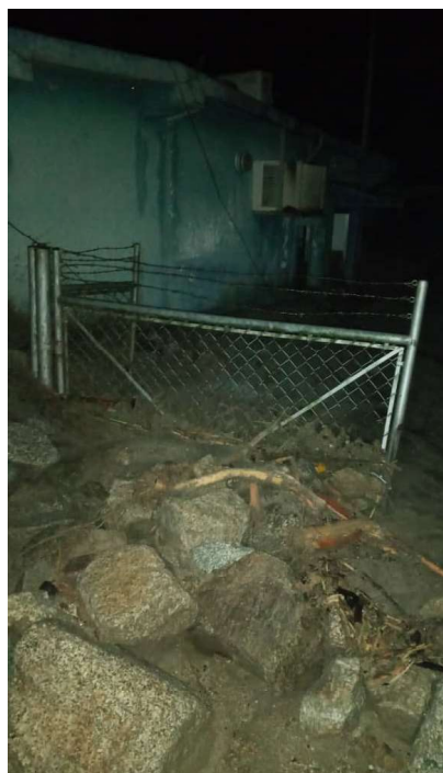
FIGURA 2. Subestación eléctrica de Tovar. Las instalaciones se inundaron y dejaron sin servicio eléctrico a gran parte del valle del Mocotíes
