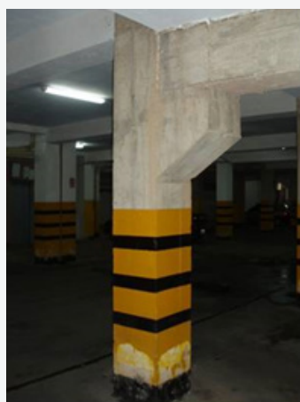
(a) Columna en estado moderado, J18, cara sureste
