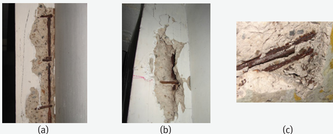
Figura. 4. Vista Frontal de la cara Sur de la Columna 1 (a), columna 3 superior (b) y columna 3 superior (c) del Sótano Nivel II, evidenciando delaminación del concreto y refuerzo expuesto, por daños por corrosión.
