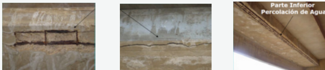
Figura 6. Daños por corrosión en tribuna no techada en la parte inferior
