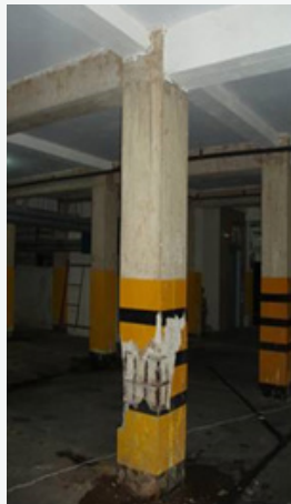
(b) Columna en estado severo, K22, cara sureste
