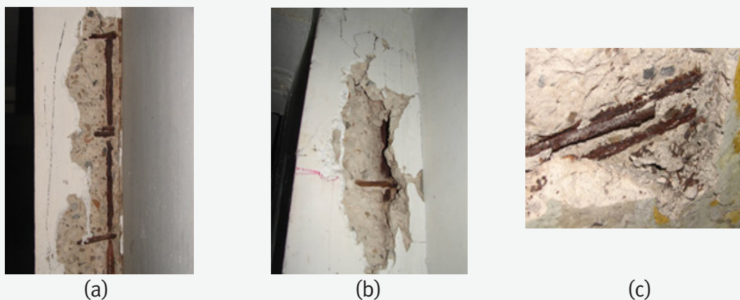
Figura. 4. Vista Frontal de la cara Sur de la Columna 1 (a), columna 3 superior (b) y columna 3 superior (c) del Sótano Nivel II, evidenciando delaminación del concreto y refuerzo expuesto, por daños por corrosión.
