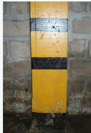
(c) Columna en estado moderado, J29, cara norte
